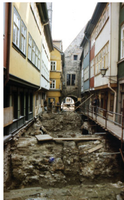
Bild 6. Freigelegte Natursteingewölbe mit erkennbarer stark reduzierter Gewölbedicke
